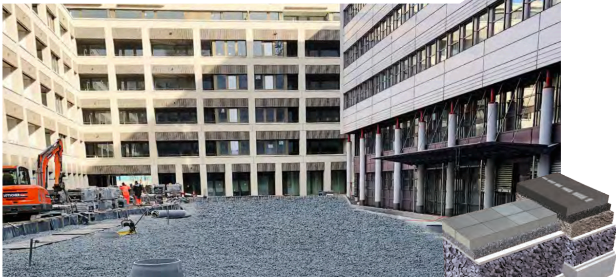
Remblai allégé MISAPOR avec surface carrossable sur parking souterrain à CH-6005 Lucerne
